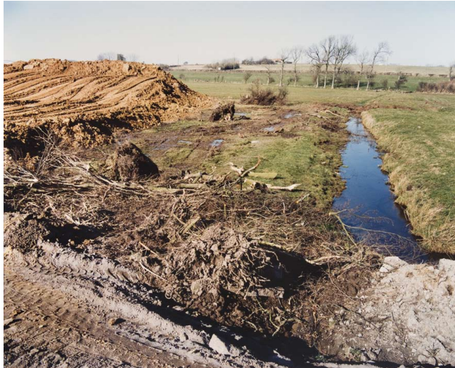
© Philippe Lesage, « Chantier du Lien Fixe Transmanche, terminal février-mars 1988 », La Rivièrelette - Coquelles , 40,2 x 50,2 cm, commande Mission Photographique Transmanche n°3, 1989, coll. CRP
